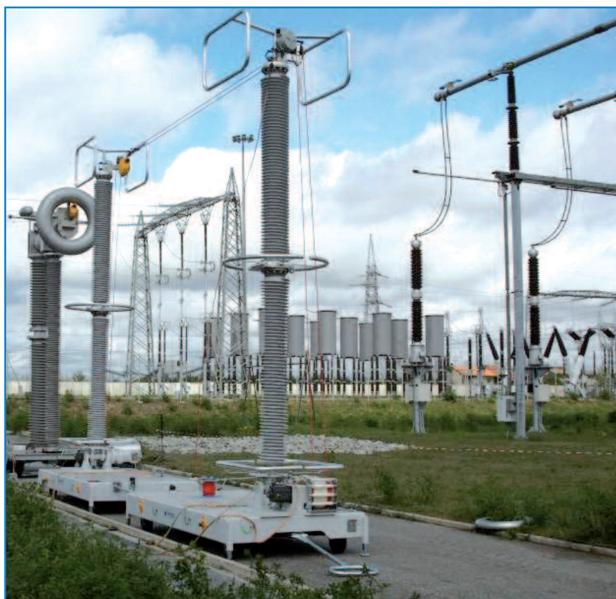
> Sistema per la verifica in campo dei trasformatori di tensione di alta tensione (RSE)
